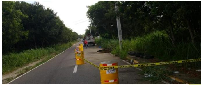
Miguel Guarocuya Cabral, lidera la solución al peligroso socavón localizado en el tronque autopista Duarte-Av. Ramón Cáceres -entrada a Moca-.
