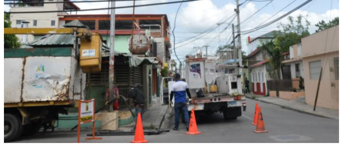
Trabajos de sustitución y renovación del sistema de semáforos de la ciudad.
