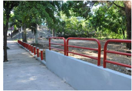
Acera peatonal en el puente del río El Caimito - sector del Hospital-.
