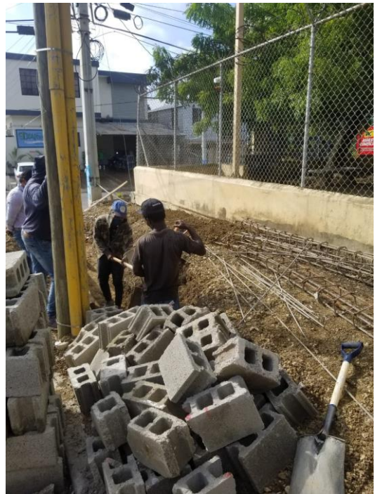
Terminación de la acera de acceso para el puente peatonal de la Ramón Cáceres, frente a la escuela El Corozo.
